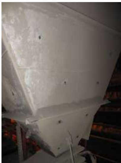
Fot. 3 Zbiornik (lej zsykowy) z widocznymi miejscami dokonywanych pomiarów grubości blachy płaszczą.
